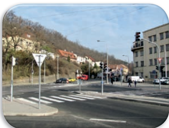
New traffic signal 4.475 U plynárny – Michelská
