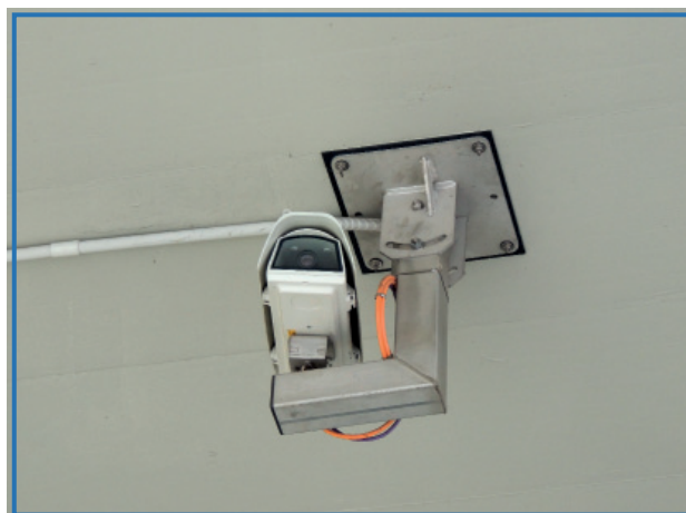
Kamera televizního dohledu v tunelu
